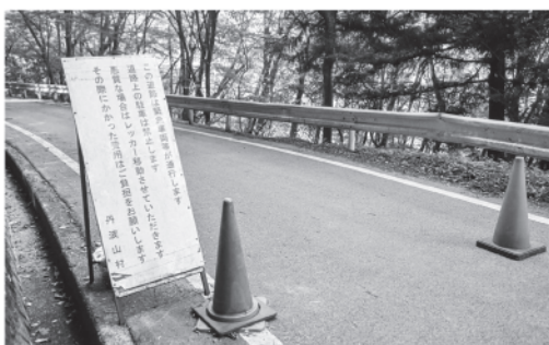
▲小袖パイロンの劣化
